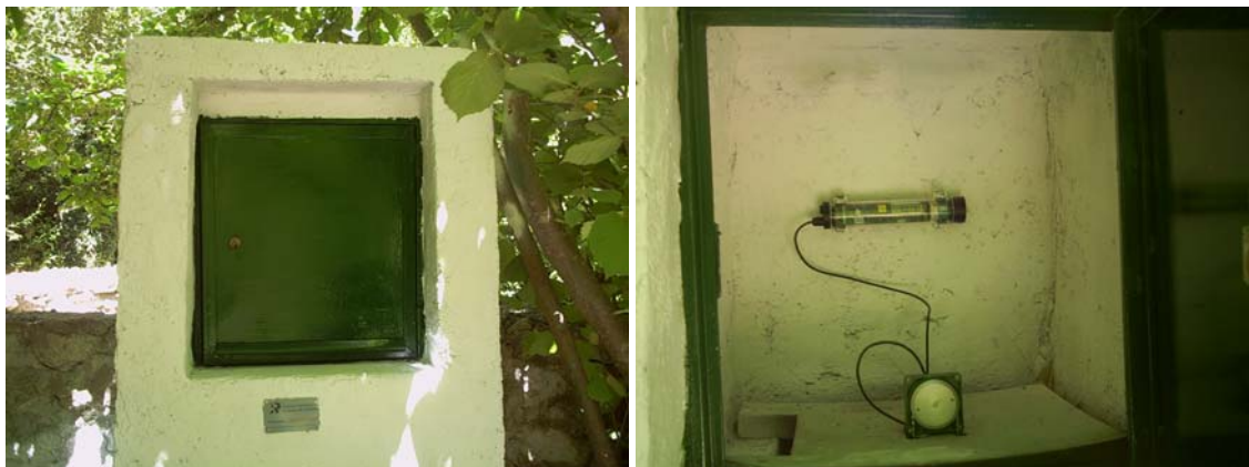
Caseta para la protección del Data Logger (Jorge Jiménez Sánchez)
